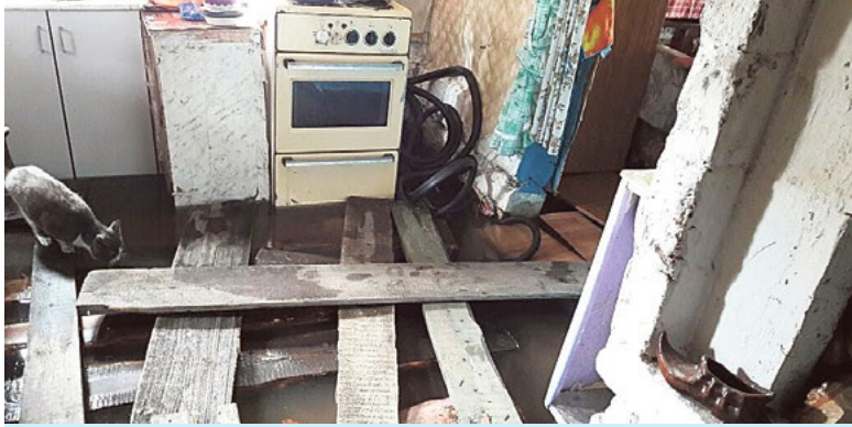
Ужасное положение в доме по улице Одарича в Черепаново, где вода стоит по щиколотку.
